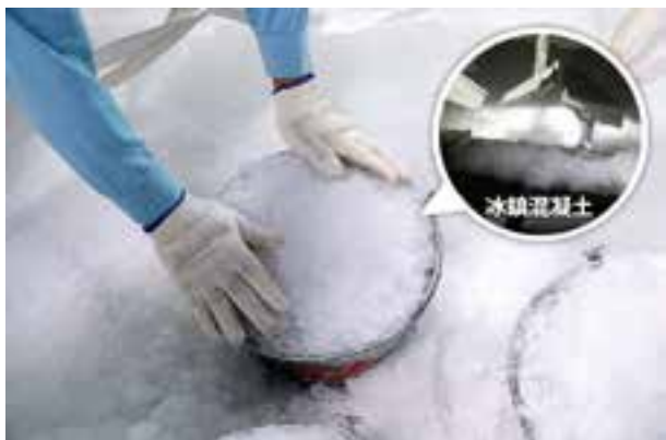
▲ 北榮重粒子癌醫中心施工過程，首度使用國產巨積混凝土「冰鎮」工法。
